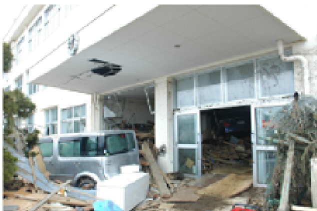
被災時の校舎（1階天井近くまで浸水）
