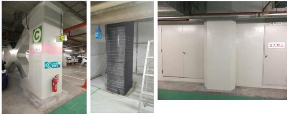
写真4.1.4 耐震補強工事の実施例（左：柱鋼板巻き立て完了 中：柱炭素繊維巻き立て施工状況 右：RC壁補強+耐震スリットの完了状況）（エスカ地下街）
