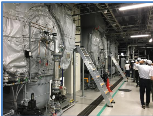
炉筒煙管式蒸気ボイラー
