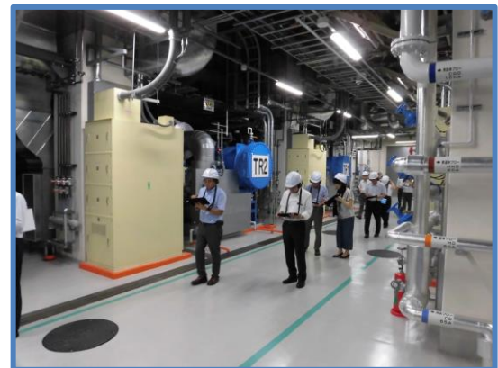
ターボ冷凍機
